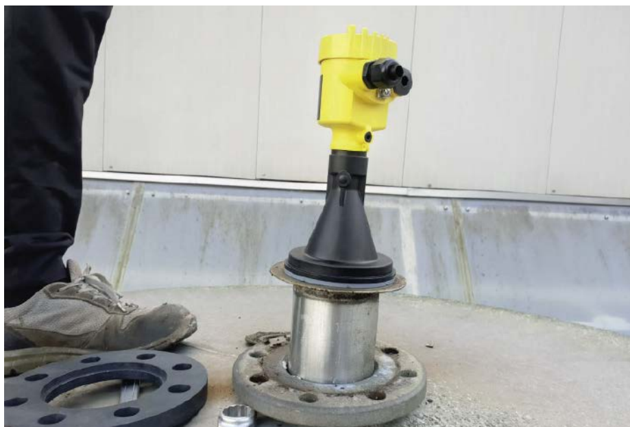
■ Abb. 2: Für alle Beteiligten in der Maismühle war die berührungslose Messung ein Pluspunkt. So mussten die Silos für die Montage der Sensoren nicht extra entleert werden.
