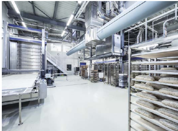
■ Abb. 2: Für die Standortzusammenführung der Bäckerei/Konditorei Zenhäusern Frères SA im Kanton Wallis realisierte IE Food die Produktion auf einer Ebene. Für künftiges Wachstum wurden bei der Planung drei weitere Ausbauphasen vorgesehen.
