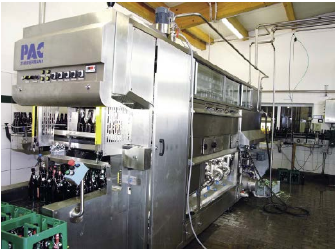
■ Abb. 2: PAC baut seine Flaschen-Waschmaschinen seit Jahrzehnten mit Komponenten namhafter Hersteller. Große Sichtfenster, ein internes Gebläse für die Abblasung der Flaschenböden, nur so viel Elektronik wie nötig.
