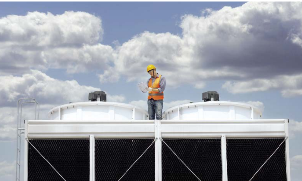
■ Abb. 1: Betreiber von Kälte- und Klimaanlage stehen vor umfassenden Aufgaben, wie z. B. regelmäßige Leckagekontrollen, Maßnahmen zur Emissionsreduzierung, die Optimierung der Energieeffizienz und viele mehr.
