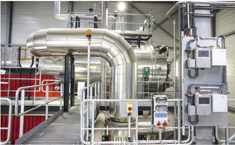
■ Abb. 2: Die Planung und der Bau oder die Optimierung einer Energieanlage sind in der Regel komplexe Aufgaben, die Zeit, Investitionen und umfangreiches Fachwissen erfordern. Contractoren sind genau darauf spezialisiert.
