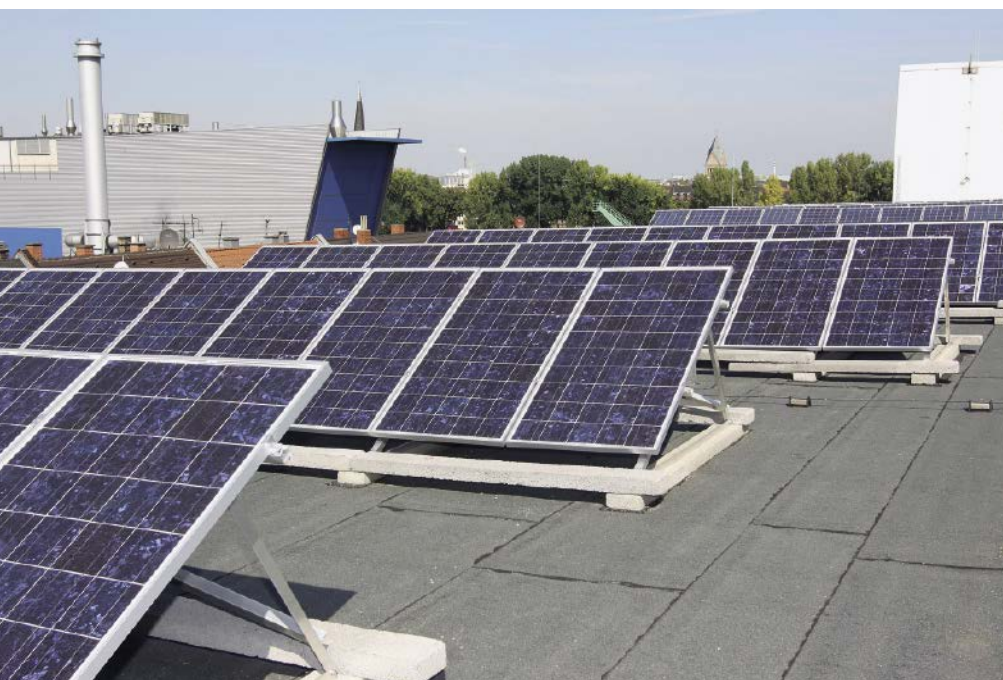
■ Abb. 1: Mittels Contracting können Unternehmen ohne eigene Investitionen von Strom aus Erneuerbare-Energien-Anlagen profitieren.
