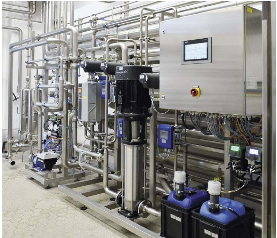
Abb. 2: Kompakt auf einem Rahmengerüst montiert: Die Grünbeck-Wasseraufbereitungsanlage in der Brauerei Frastanz. Ihr Herzstück ist die Umkehrosmoseanlage Geno-Osmo-RKF 12.500, die pro Stunde bis zu 12,5 m 3 vollentsalztes Wasser liefert, das in der nachgeschalteten Verschnideeinrichtung mit Rohwasser vermischt wird, um die optimale Brauwasserhärte zu erreichen.
