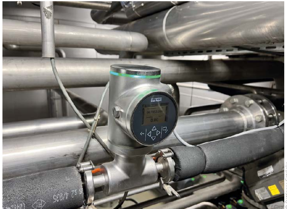
■ Abb. 2: Für die Dosierung und Messung von Hopfenextrakt wurde vor dem Zulauf zur Würzpfanne ein SAW-Durchflussmesser installiert.
