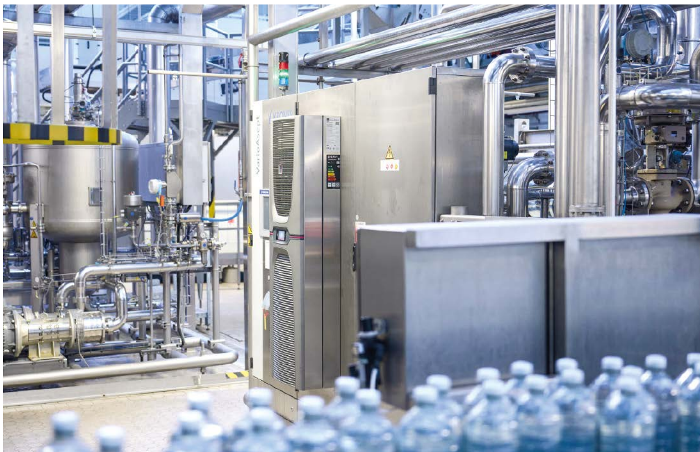
Abb. 4: Rittal Blue e+ Schaltschrankkühlung im Einsatz bei Coca-Cola Europacific Partners
