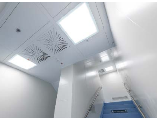
Abb. 5: Reinraum-Treppenhaus mit Deckendetails wie Luftauslässen, Sprinklerköpfen und Sensoren
