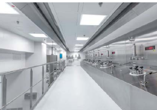
Abb. 4: Pufferansatzraum: Integration einer Bedienbühne in den Reinraum, sämtliche Installationen im Technikbereich dahinter, nur notwendige Ausstattungen im Reinraum integriert (z.B. Handlöcher großer Ansatzbehälter)
